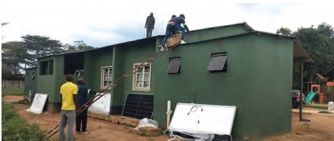
Solar-Installation an unserem Wohnheim
